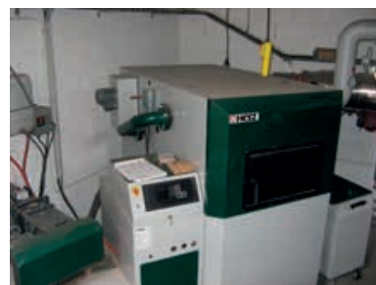
Chaudière HERZ 250 kW
